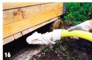
16 В предусмотренный ранее просвет в фундаменте протолкнули конец сливного шланга, обёрнутый тряпкой.
