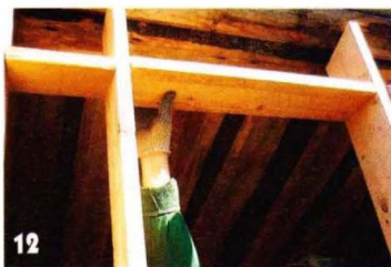
12 Начали с замены двери в душ, а пришлось менять и каркас всей стены.
